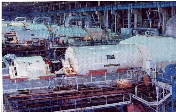
(Турбоагрегаты 150 МВт. Литовская ГРЭС)
